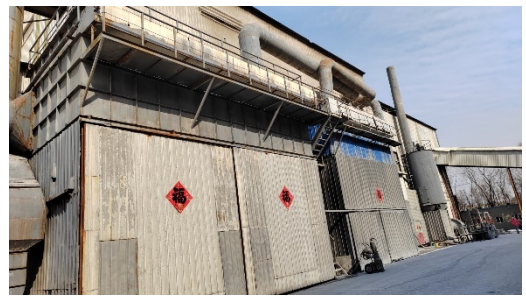
电弧炉除尘系统
