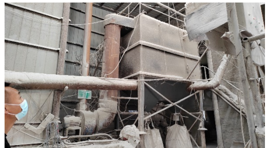
颚式破碎机除尘器
